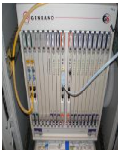
Рисунок 1 Общий вид оборудования с открытой дверью
