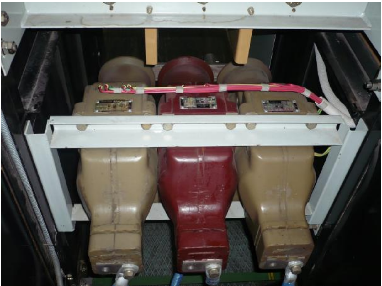
Рисунок 1 – Внешний вид трансформаторов
