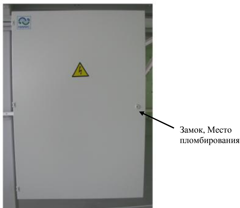
Рисунок 3 - Внешний вид шкафа УСОИ с закрытой дверцей
