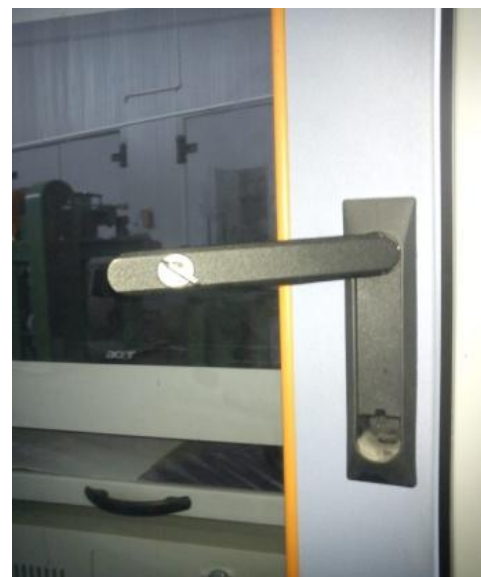
Рисунок 3 – Внешний вид замка на дверце стойки управления
