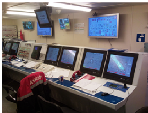
Станция оператора и обслуживания (ЧМИ)
