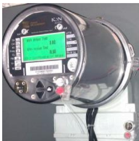
Рисунок 1. Внешний вид счётчиков электроэнергии многофункциональные ION 8300
