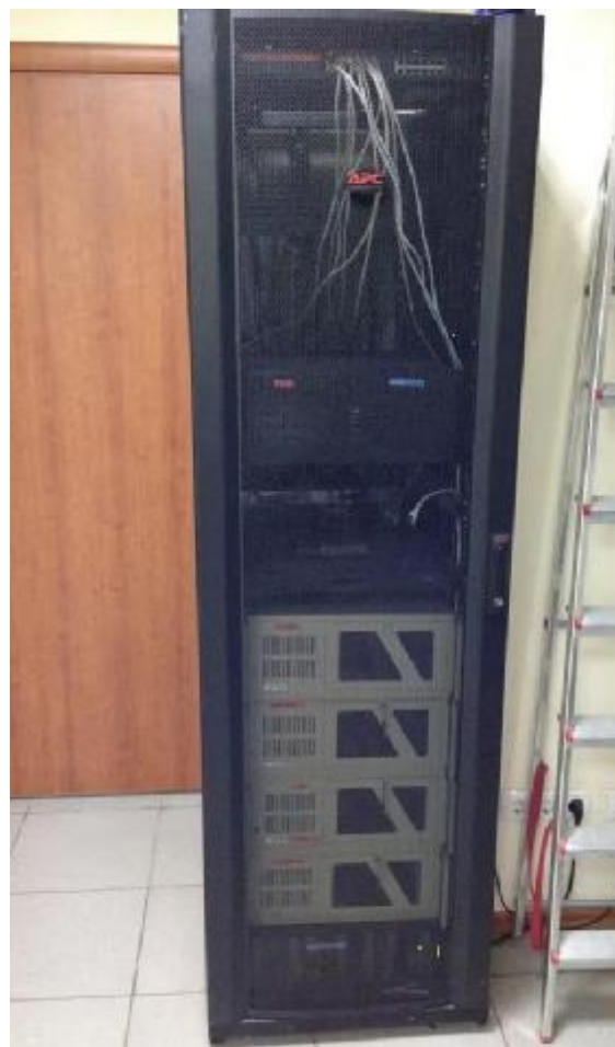
Рисунок 2 Оборудование в стойке с закрытой дверью и замком от несанкционированного доступа
