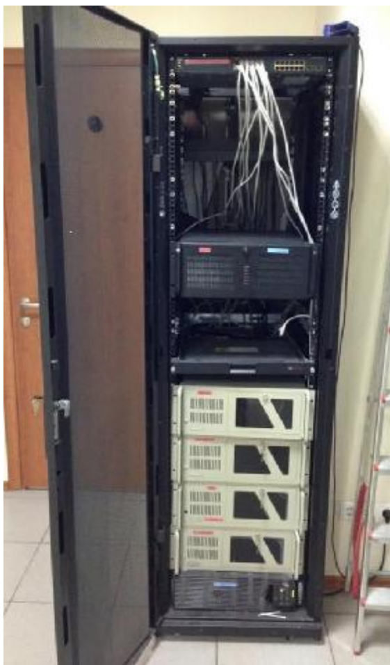
Рисунок 1 Общий вид оборудования с открытой дверью.
