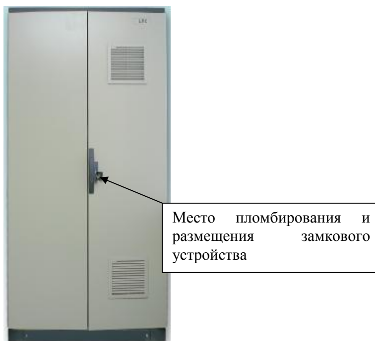
Рис. 1 - Внешний вид приборного шкафа
