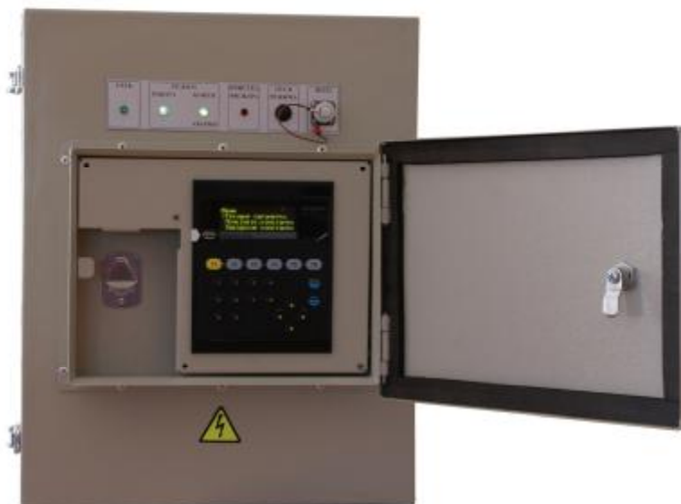
Фото 2 - Общий вид блока измерений и обработки информации БИОИ-5
