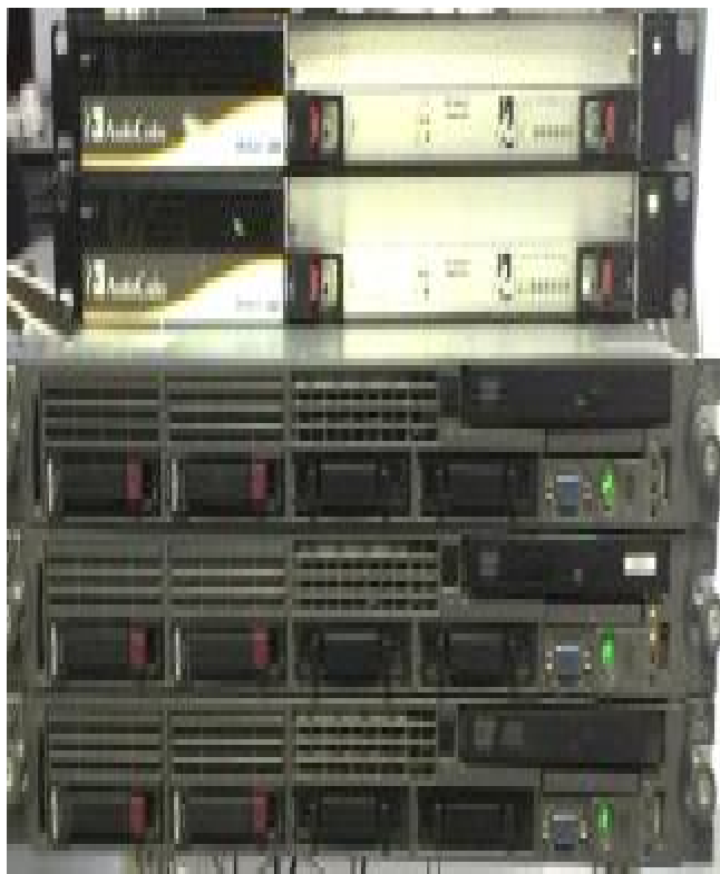
Рисунок 1 Общий вид оборудования с открытой дверью
