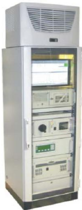
Рис.2. Внешний вид шкафа с приборной стойкой и приборами системы Gaset CEMS II (стационарное исполнение)
