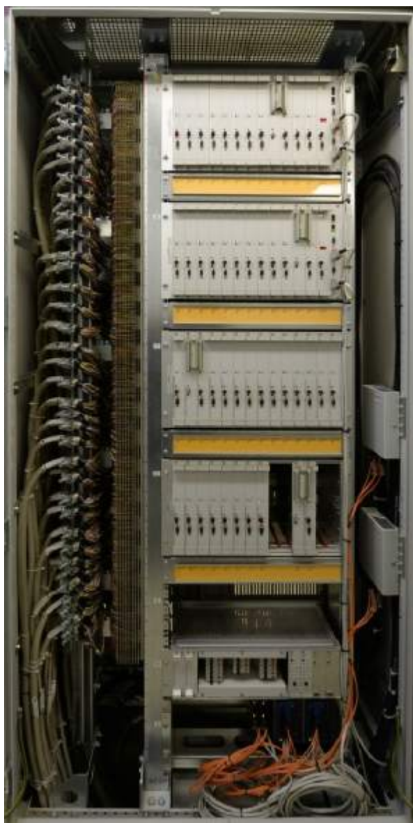
Рисунок 2 - Внешний вид электротехнического шкафа со средствами программно-техническими ТПТС-ЕМ
