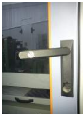
Рисунок 9 – Внешний вид замка на дверце стойки управления
