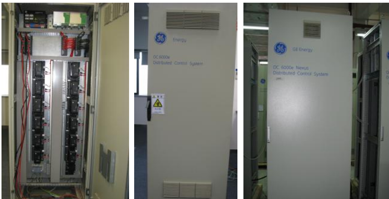
Рисунок 2 – Внешний вид приборного шкафа ИВК ОС 6000е, ОС 6000е Nexus.
