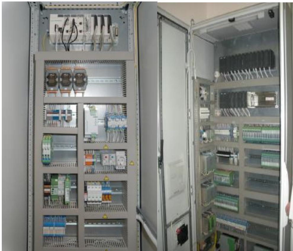
Рисунок 1 – Фото общего вида шкафов комплексов.
