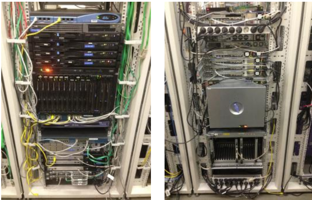
Рисунок 1 - Общий вид оборудования спереди и сзади с открытой дверью шкафа
