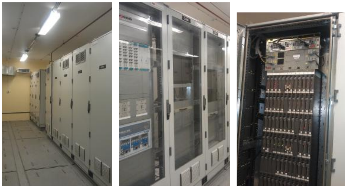
Рисунок 1. Фото общего вида шкафов комплекса
