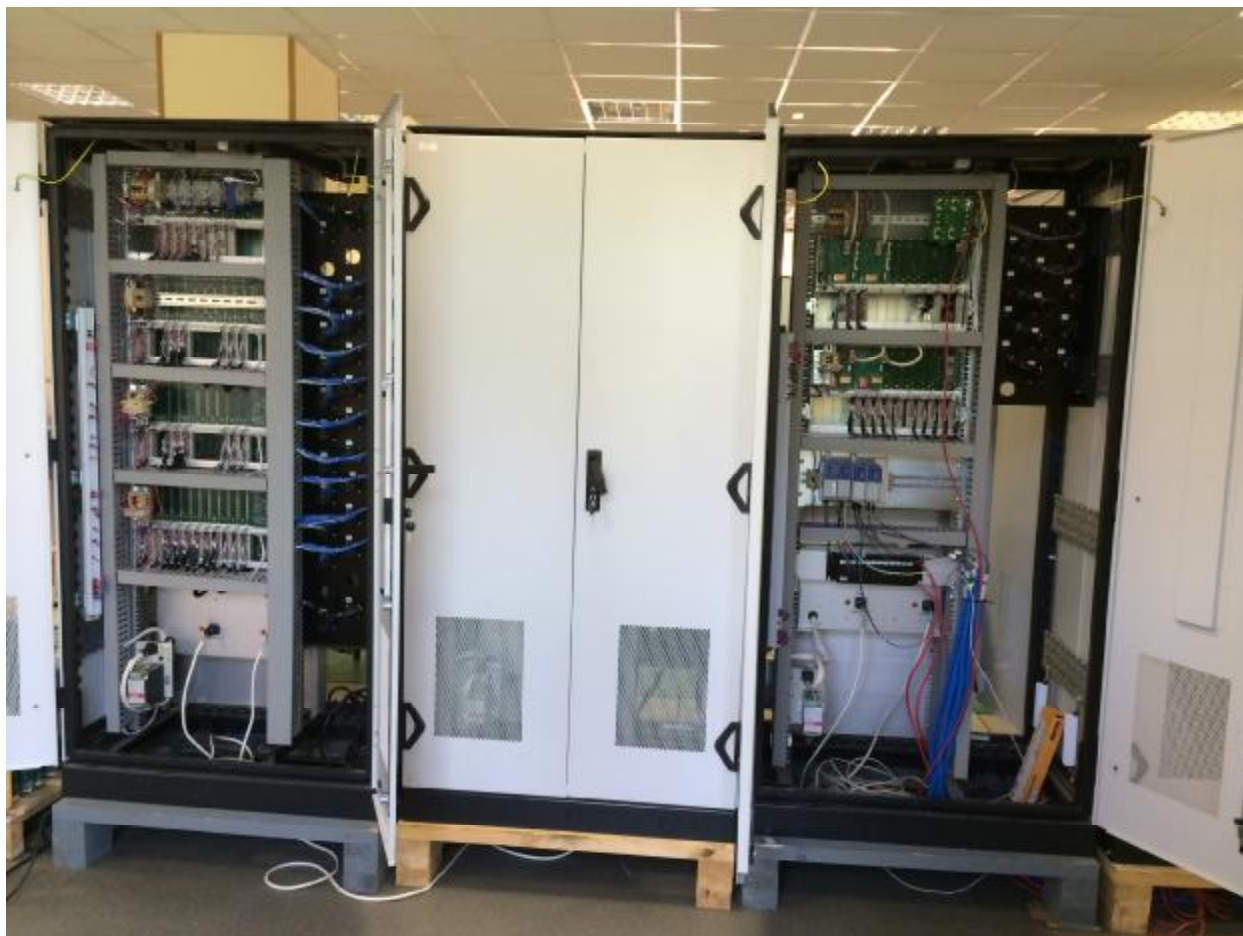
Рисунок 2 Фото общего вида шкафов аппаратуры «Гиндукуш-М»
