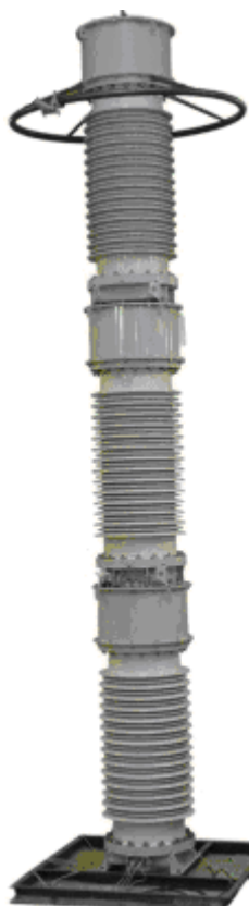
Трансформатор напряжения НАМИ-330
