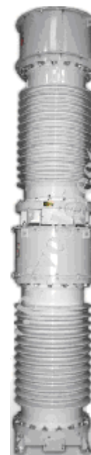
Трансформатор напряжения НАМИ-220
