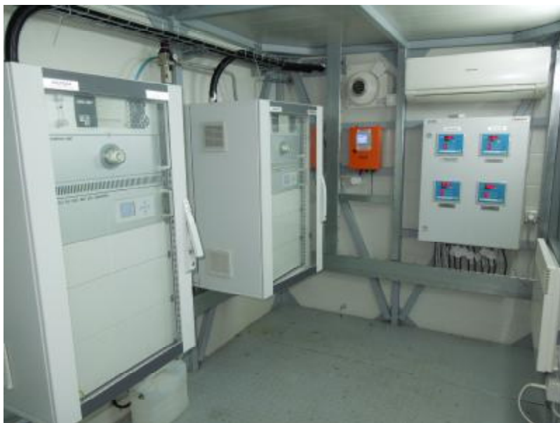
Рис.2 Вид комплекса КЭМ внутри контейнера.
