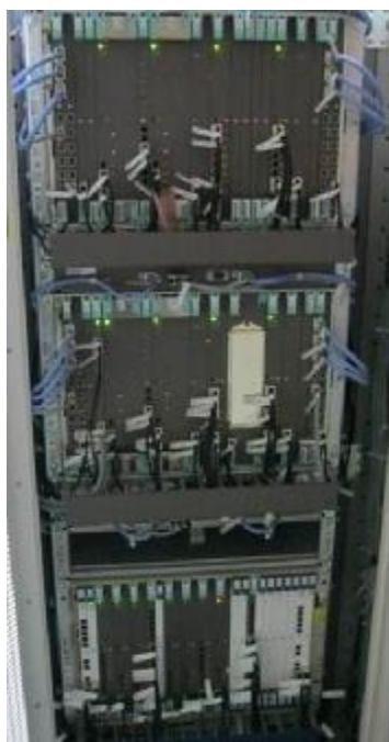
Рисунок 1 - Общий вид оборудования с открытой дверью
