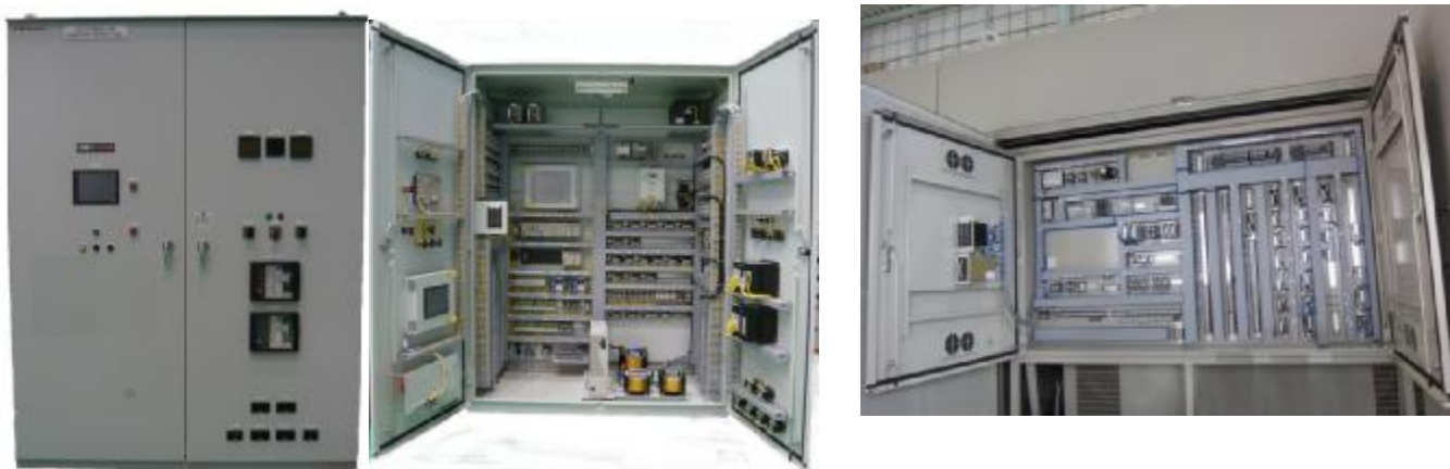
Приборные шкафы ИВК
