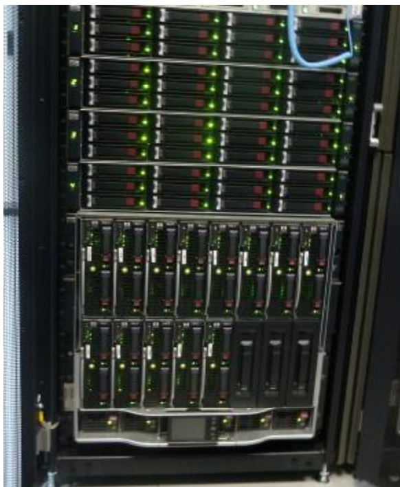
Рисунок 1 - Общий вид оборудования с открытой дверью
