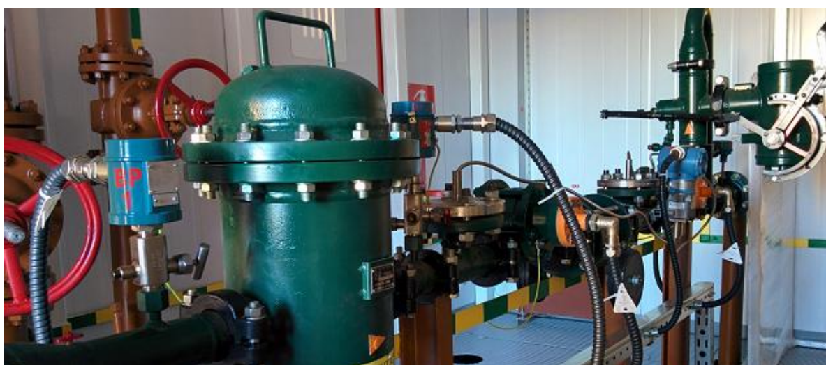
Фото 3 - Общий вид измерительной линии установки
