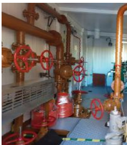
Фото 1 - Общий вид распределительного модуля
