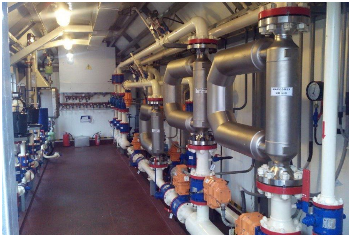
Рисунок 1 - Общий вид СИКН
