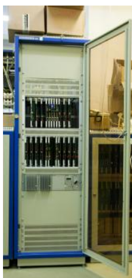
Рисунок 1 - Общий вид оборудования с открытой дверью шкафа
