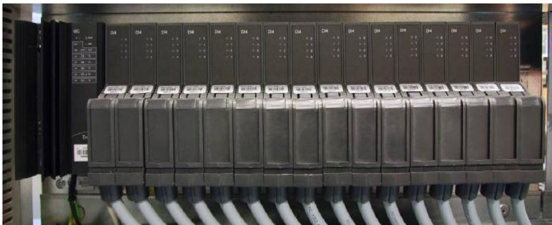
Рисунок 2 – Фото общего вида комплексов в электротехническом шкафу
