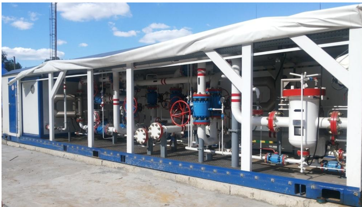
Рисунок 1 – Общий вид СИКН
