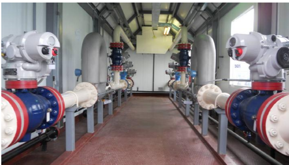
Рисунок 1 – Общий вид СИКН
