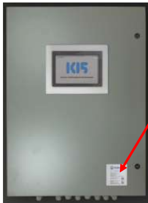
Рисунок 1 – Контроллер в шкафу общепромышленного исполнения
