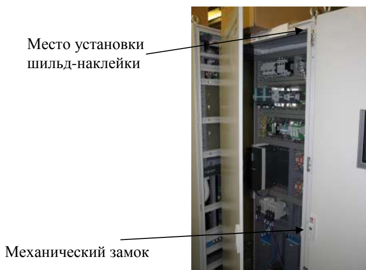
Рисунок 1 - Контроллер в приборном шкафу
