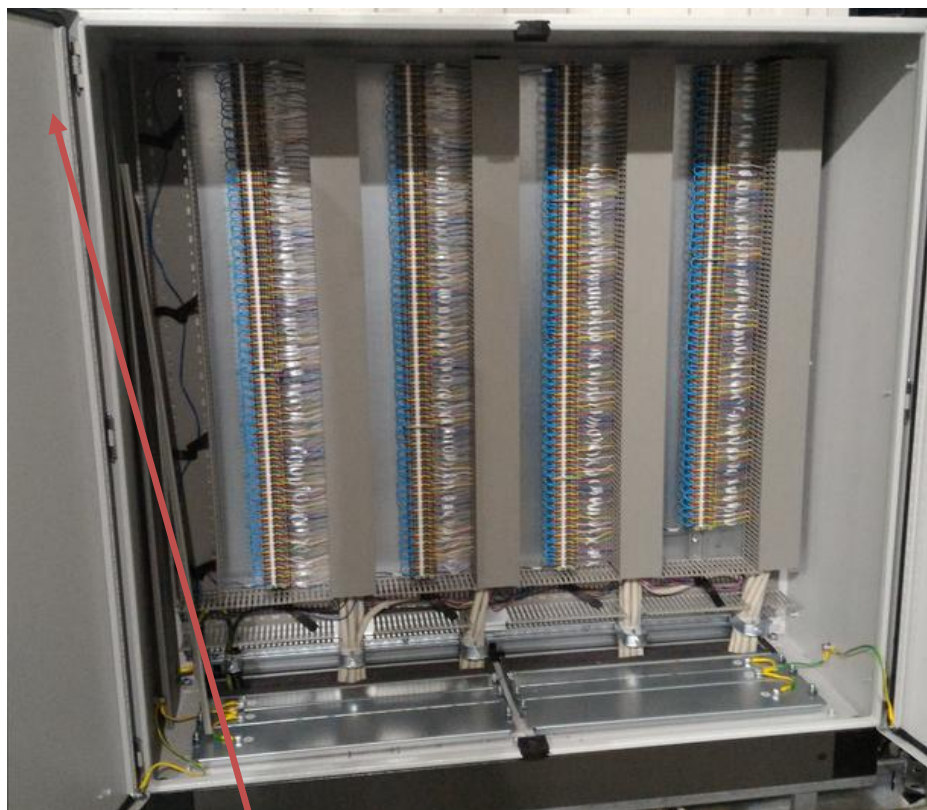
Рисунок 3 - Шкаф кроссовый 1 Место нанесения знака поверки
