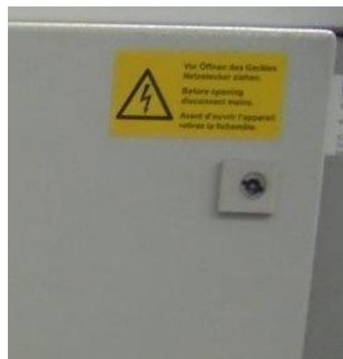
Рисунок 4 – Замок на дверце распределительного шкафа.
