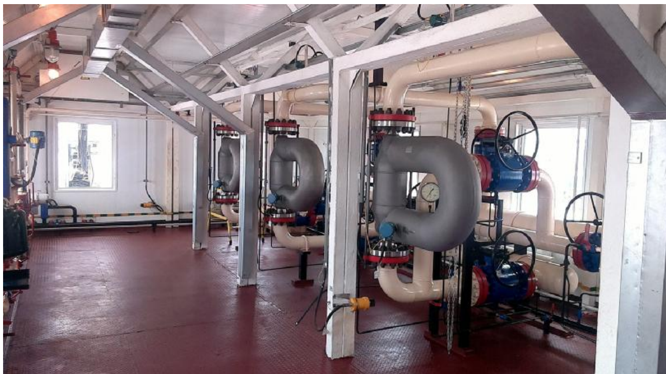
Рисунок 1 – Общий вид СИКН
