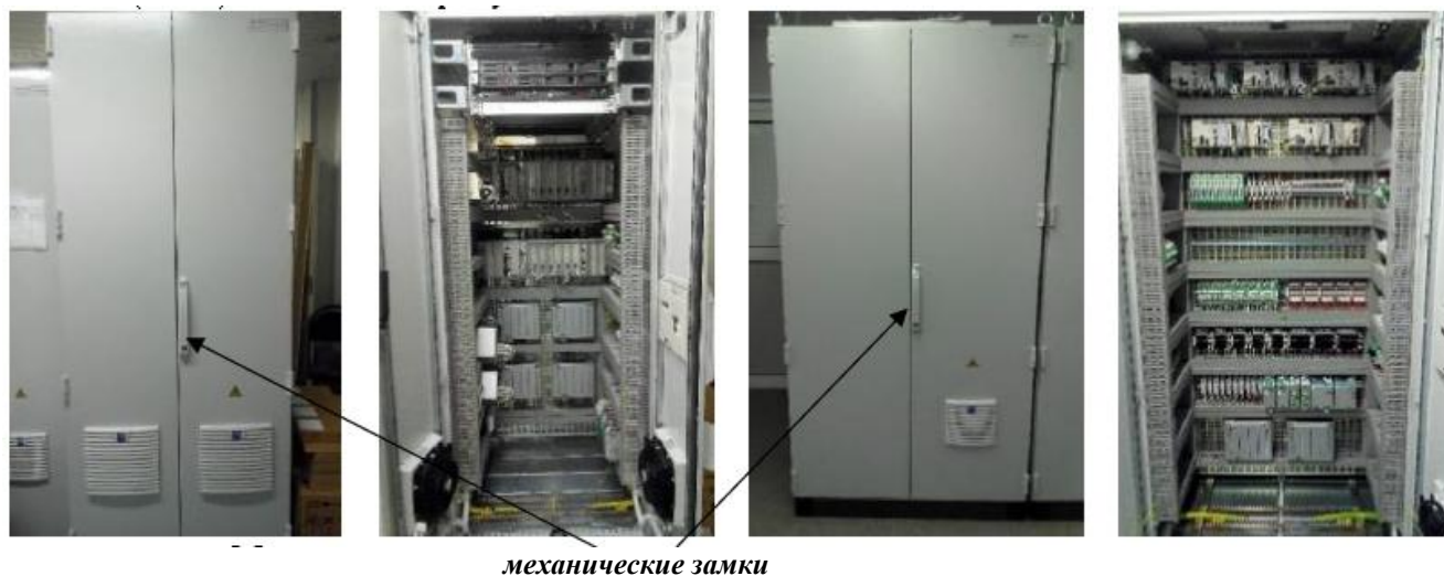
Рисунок 1 - Внешний вид шкафов комплекса
