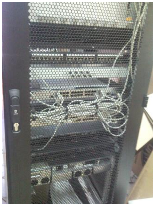
Рисунок 1 - Общий вид оборудования с закрытой дверью
