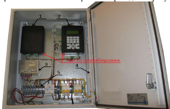
Рисунок 1 - Общий вид блока измерительного ИС-14.М 1 - вычислитель; 2 - контроллер ИС-14.М; 3 - источник питания; 4 - лампа освещения; 5 - клеммная колодка
