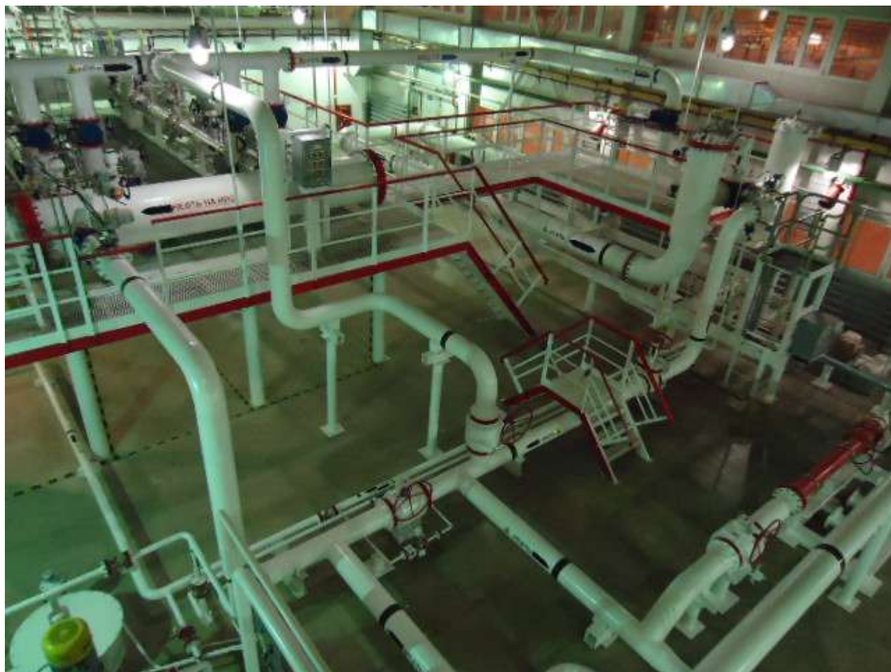
Рисунок 1 - Общий вид СИКН
