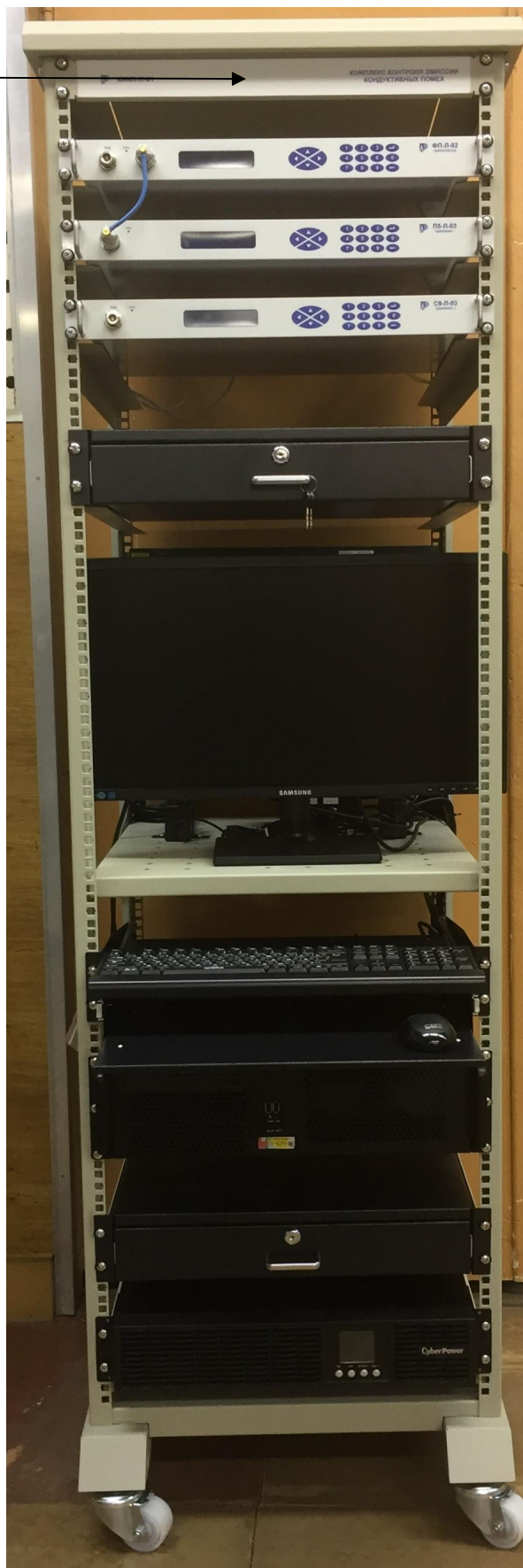
Рисунок 1 - Общий вид стойки с оборудованием комплекса (вид спереди)
