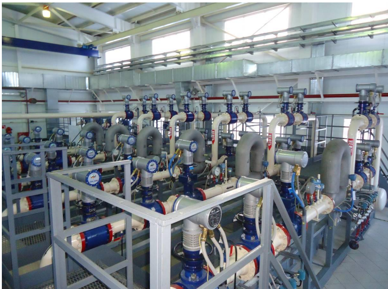
Рисунок 1 - Общий вид СИКН
