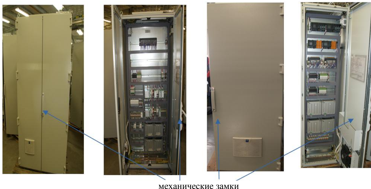
Рисунок 1 - Внешний вид шкафов комплекса
