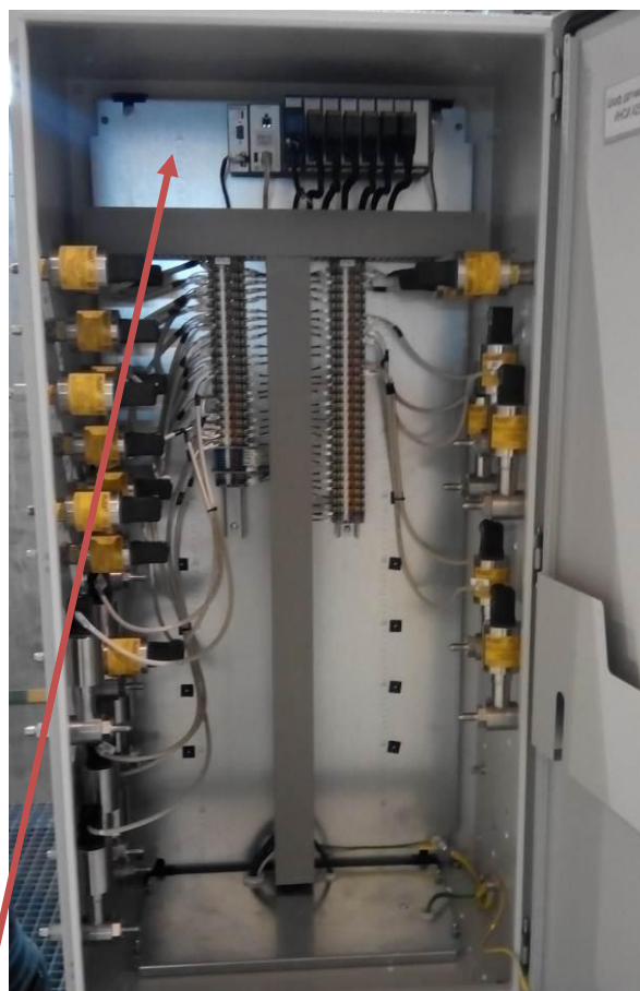
Рисунок 4 - Шкаф датчиков давления 2
