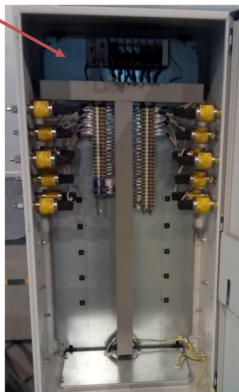
Рисунок 6 - Шкаф датчиков давления 4
