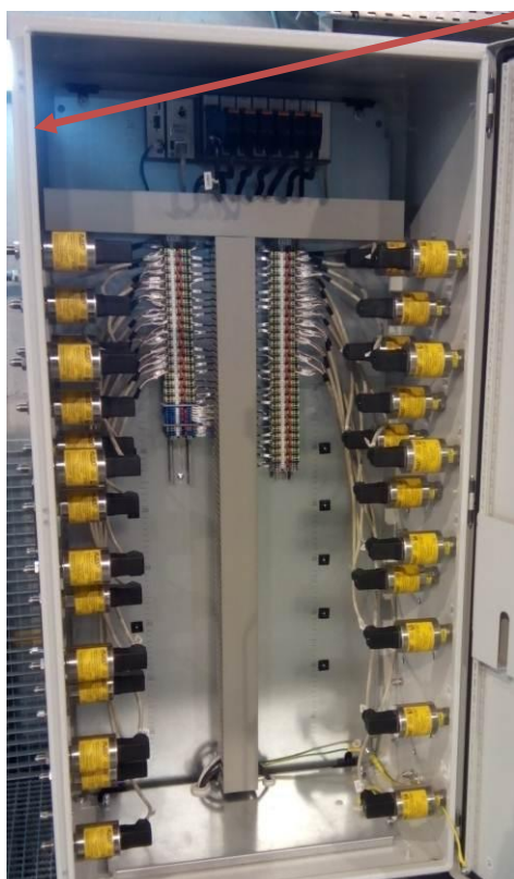
Рисунок 5 - Шкаф датчиков давления 3
