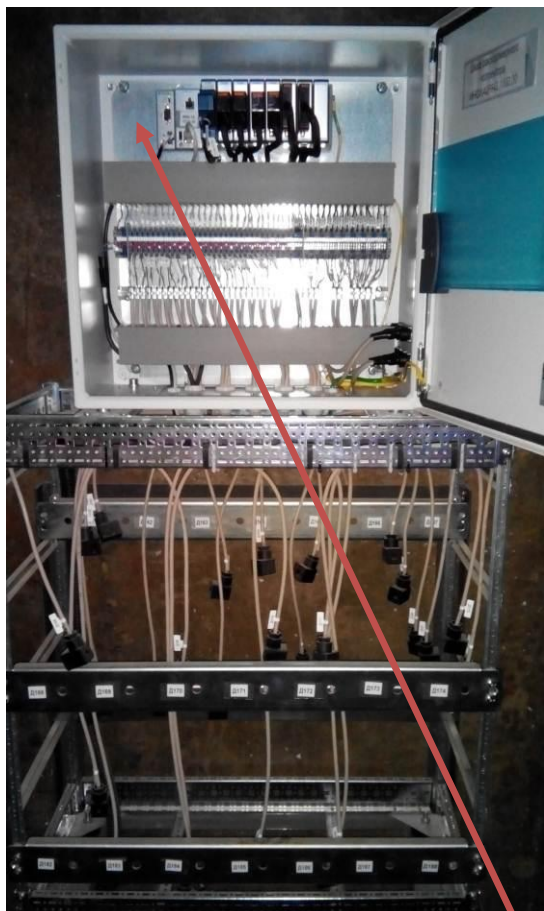
Рисунок 11 - Шкаф расходомерного коллектора
