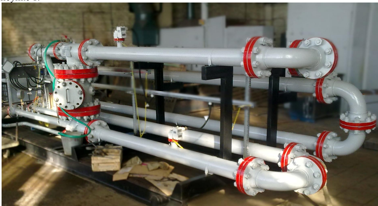
Рисунок 1 – Общий вид установки трубопоршневой ТПУ «Сапфир НГИ-300»
