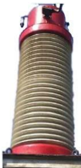
Рисунок 1 - Общий вид трансформаторов тока
