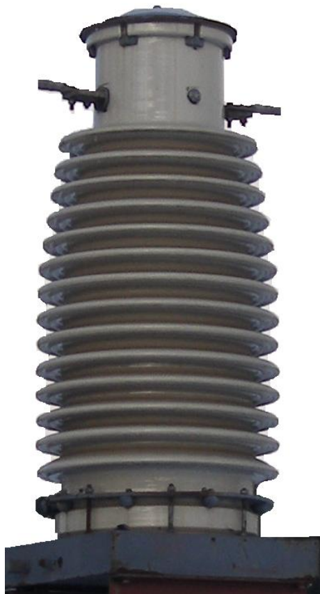
Рисунок 1 - Общий вид трансформаторов тока
