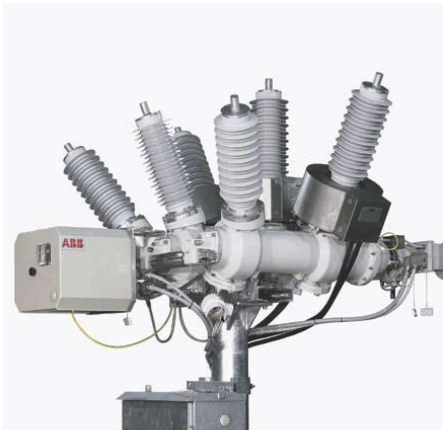
Рисунок 1 - Общий вид трансформаторов тока
