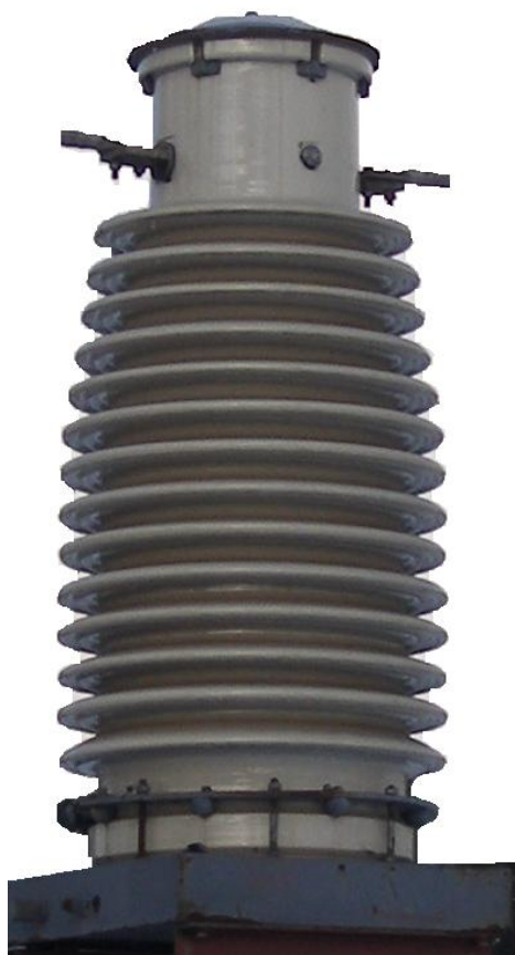
Рисунок 1 - Общий вид трансформаторов тока
