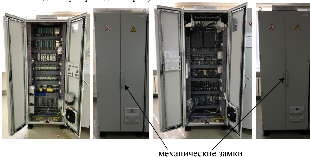
Рисунок 1 - Внешний вид шкафов комплекса
