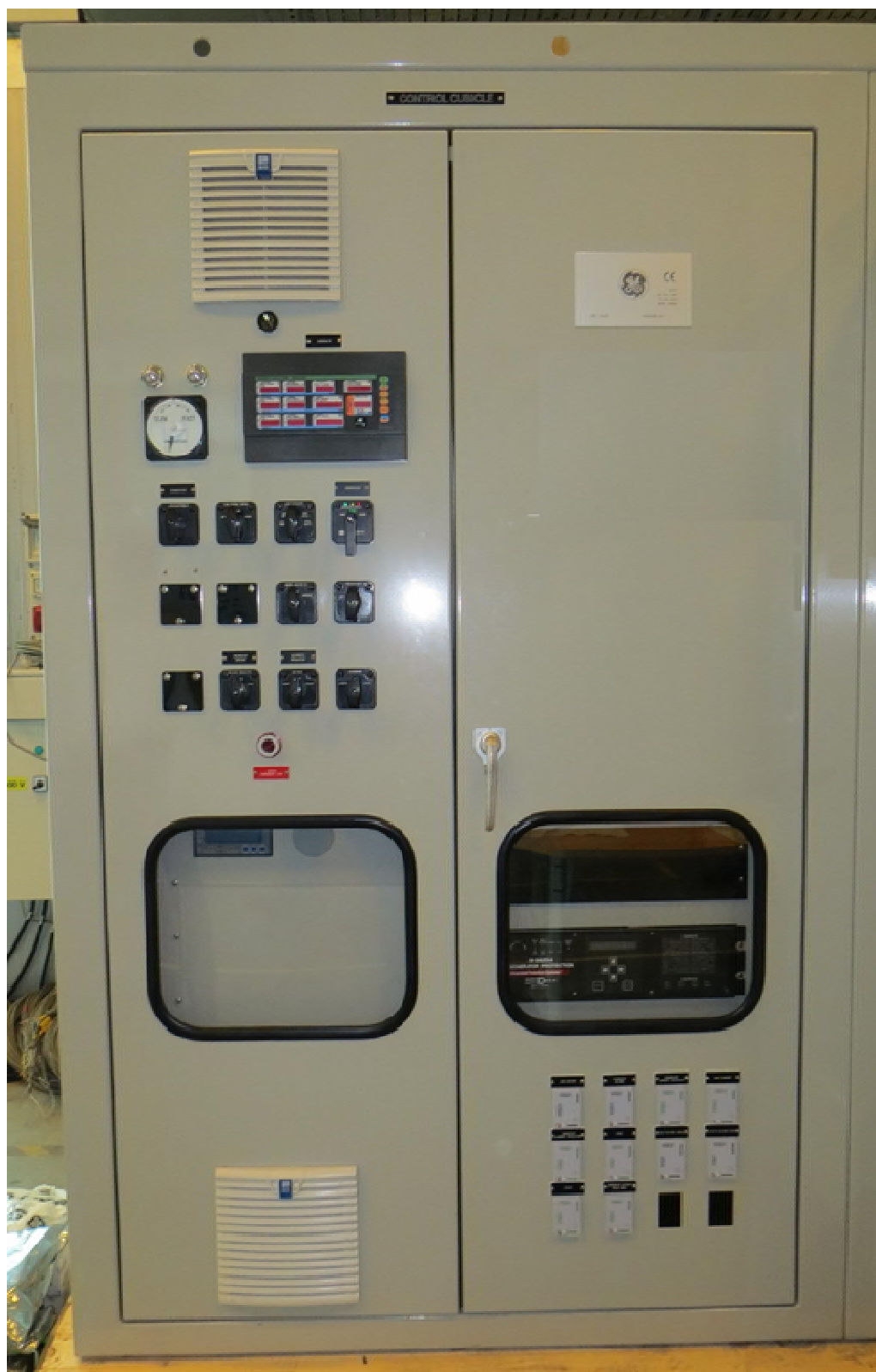
Рисунок 1 - Общий вид шкафов управления систем МТТВ, МГТВ и ТСП
