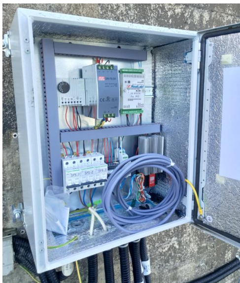
Рисунок 1 - Общий вид интеграционного шкафа
